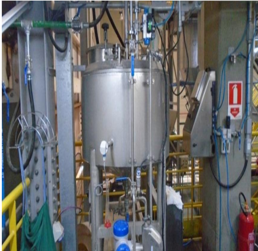
Figura 4.9 - Tanque dosador de fluido. (Autor, 2020).
