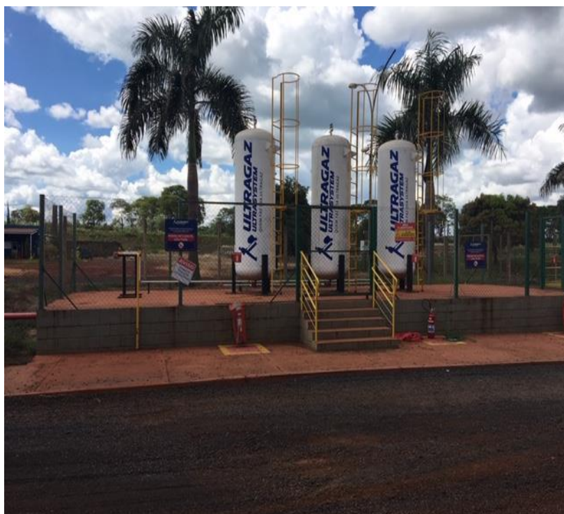
Figura 4.24 - Estação de fornecimento do gás GLP (Autor, 2020).
