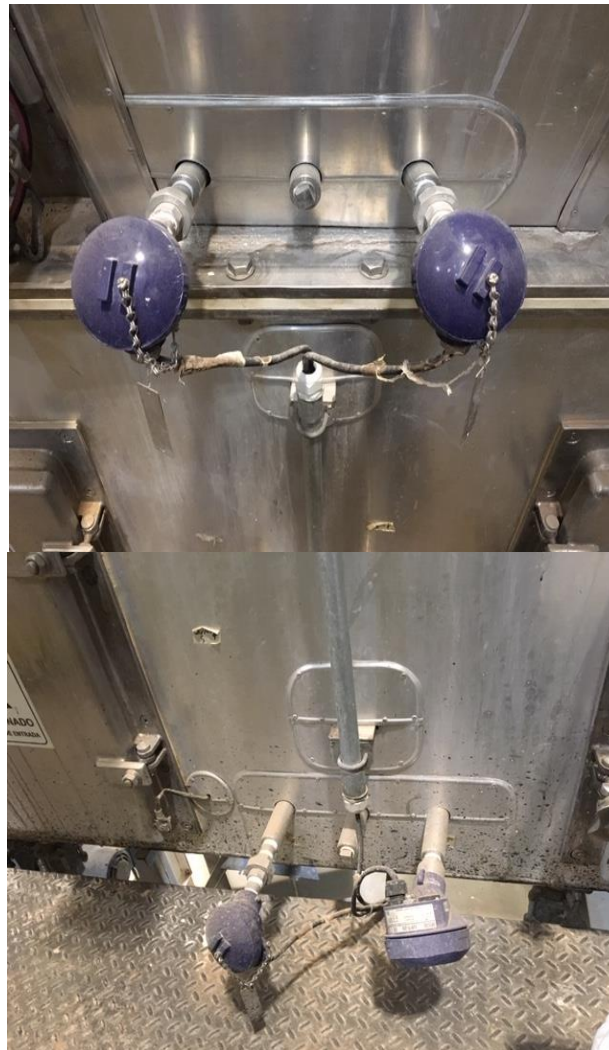
Figura 4.22 - Controles de automação Termostatos na parte superior e inferior das câmaras (Autor, 2020).
