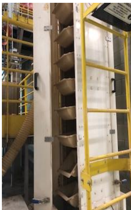
Figura 4.25 - Elevador de canecas. (Autor, 2020).
