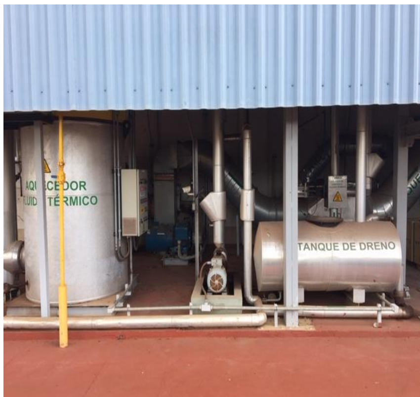
Figura 4.23 - Sistema de Armazenagem de fluido térmico BPF e queimador. (Autor, 2020).
