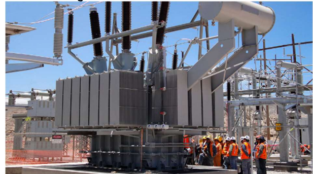
Figura 4 - Transformador de Potência
