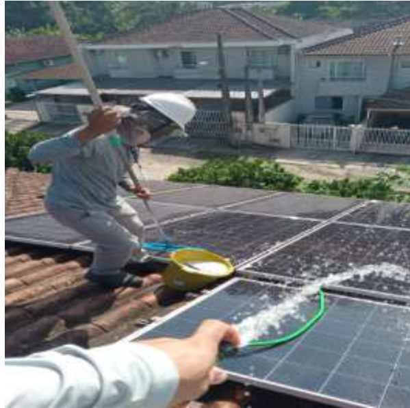
Figura 1 - Manutenção dos módulos em telhado sem linha de vida.
