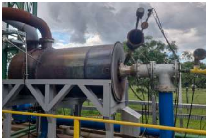
Figura 31 - Câmara de Combustão
