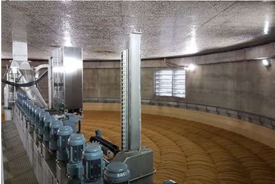
Figura 3 - Exemplo de equipamento de malteação
