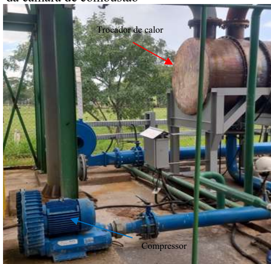
Figura 33 - Compressor de ar e trocador de calor da câmara de combustão
