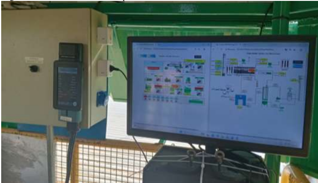
Figura 40 - Tela de monitoramento espelhada instalada na chaminé
