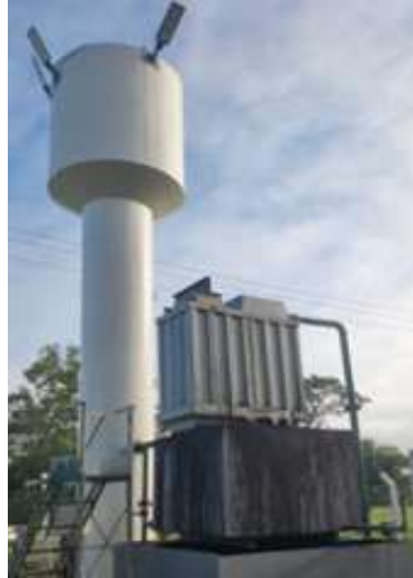
Figura 30 - Reposição de água e condensador evaporativo
