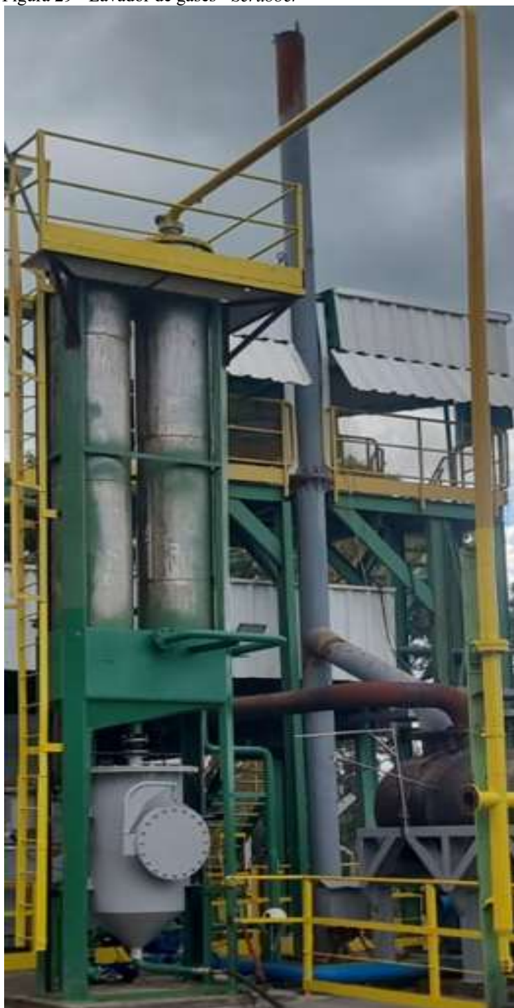
Figura 29 - Lavador de gases - Scrubber
