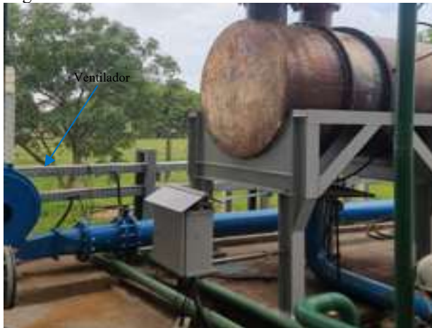
Figura 32 - Ventilador de ar da câmara de combustão.
