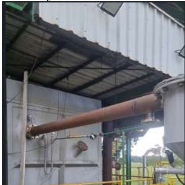
Figura 28 - Tubulação de saída do gás de síntese para o lavador de gases
