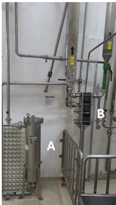
Figura 21: Linha de entrada de água da utilidades para a bateadeira (sistema de lavagem). Na imagem é possível ver um filtro (A) e um trocador de calor (B) para resfriamento da água. Fonte: Do autor (2024).
