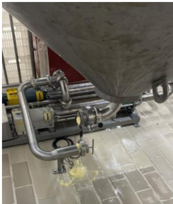
Figura 45: Residual orgânico nas conexões entre remessas. Fonte: Do Autor (2024).
