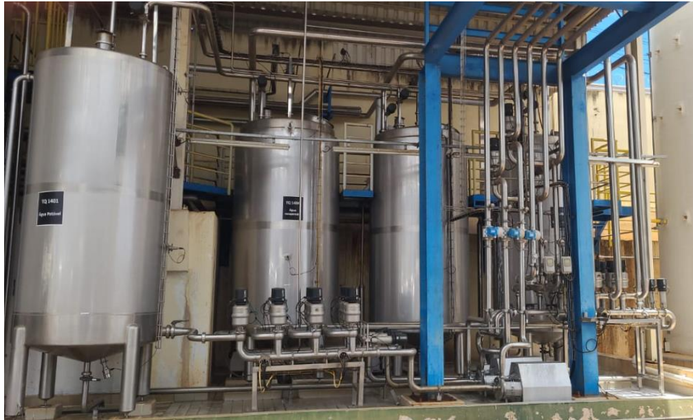
Figura 29: Conjunto da Central CIP. Fonte: Do autor (2024).
