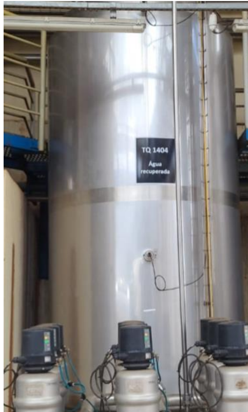
Figura 31: Tanque de água recuperada da Central CIP Fonte: Do autor (2024).
