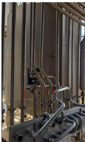
Figura 18: Silo de creme pasteurizado utilizado para o processo de manteiga. Denominado de “Silo 6”. A frente, encontra-se a placa de fluxo dos silos 5 e 6. Fonte: Do autor, (2024).
