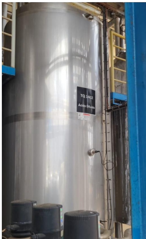
Figura 33: Tanque de ácido diluído da Central CIP. Fonte: Do autor (2024).
