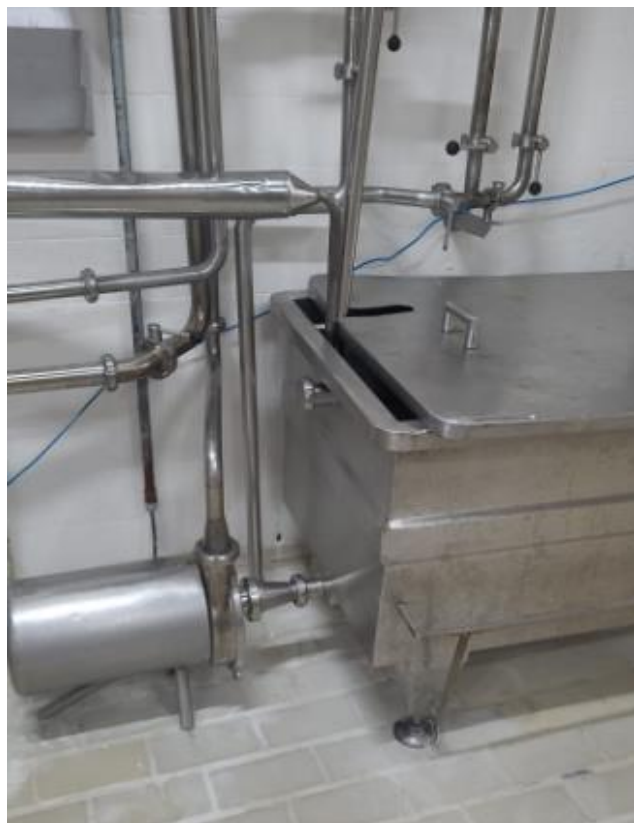
Figura 51: Tanque de solução e bomba de CIP in loco .
