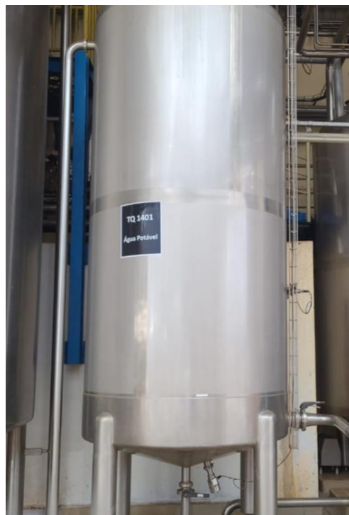
Figura 30: Tanque de água potável da central CIP. Fonte: Fonte: Do autor (2024).
