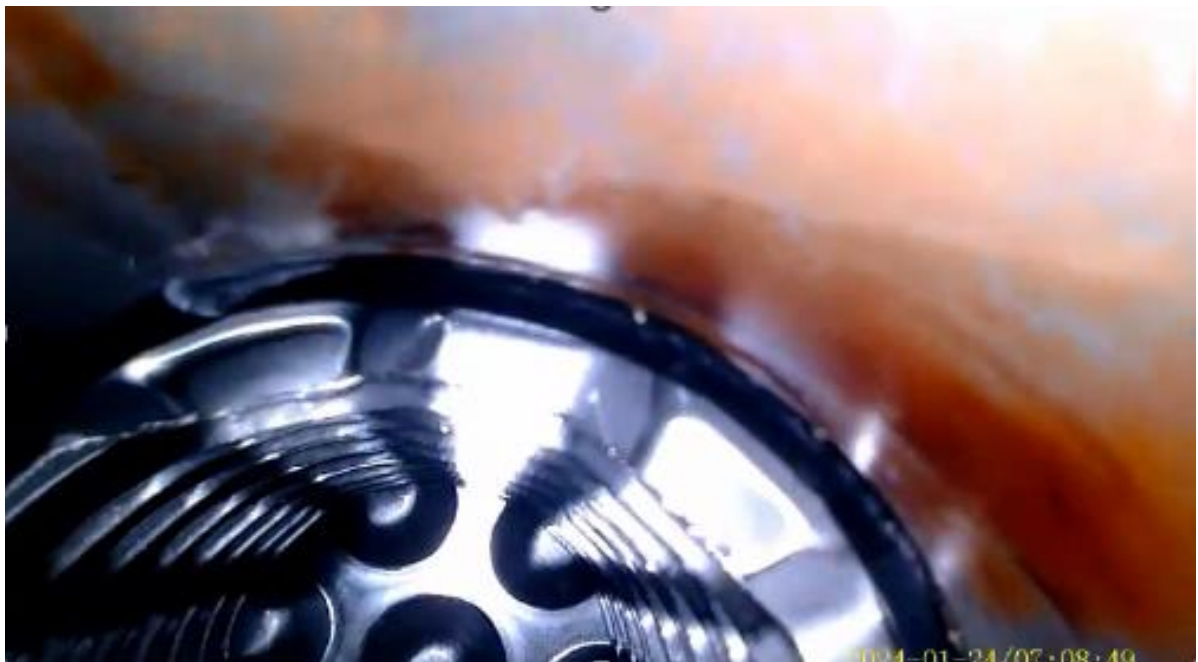
Figura 38: Presença de oxidação na linha, antes da entrada do trocador. Fonte: Do Autor (2024).
