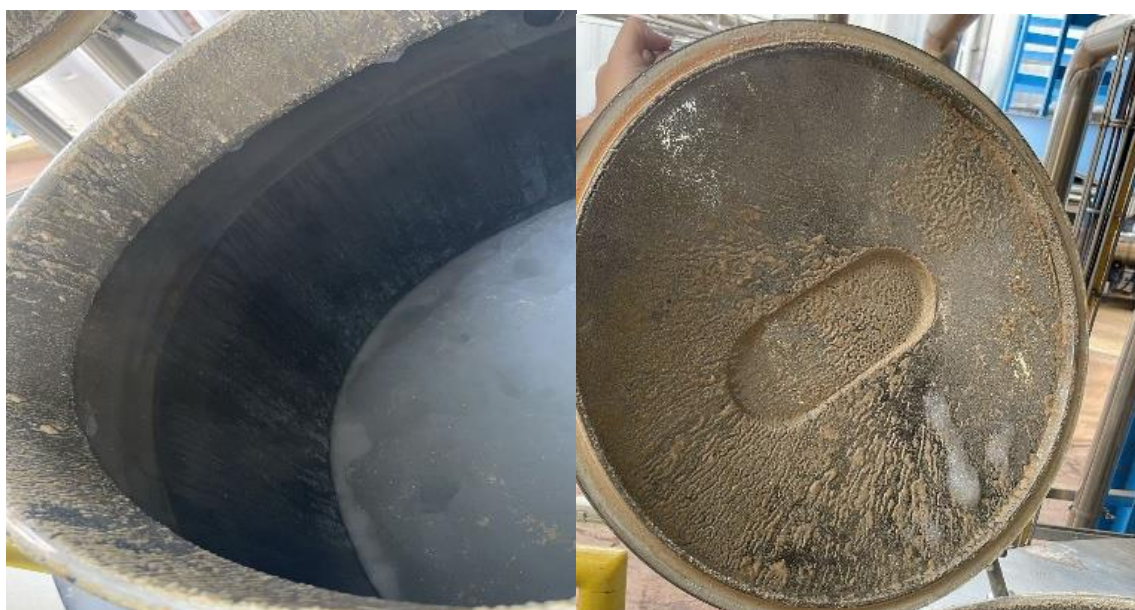
Figura 47: Residual orgânico no tanque de solução alcalina na Central CIP. Fonte: Do Autor (2024).
